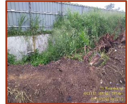
Cross drain tertutup material konstruksi dan tidak difungsikan
