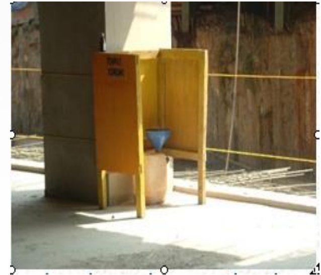
TEMPAT BUANG AIR KECIL DI LOKASI PROYEK
